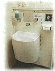
・オストメイト対応設備
